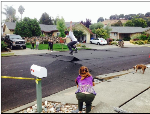
Un skate-boarder profitant des déformations provoquées par le séisme du 2 Août 2014 – Baie de San Francisco -
